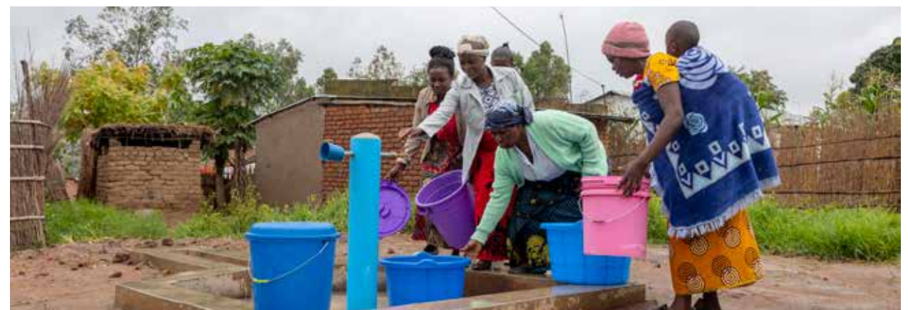
L'eau du forage est traitée, ce qui permet à la communauté de Chimbiya d'avoir de l'eau potable. Crédit photo : SADC-GMI.
